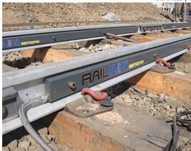
Balança da DM instalada em Cacequi (RS).
